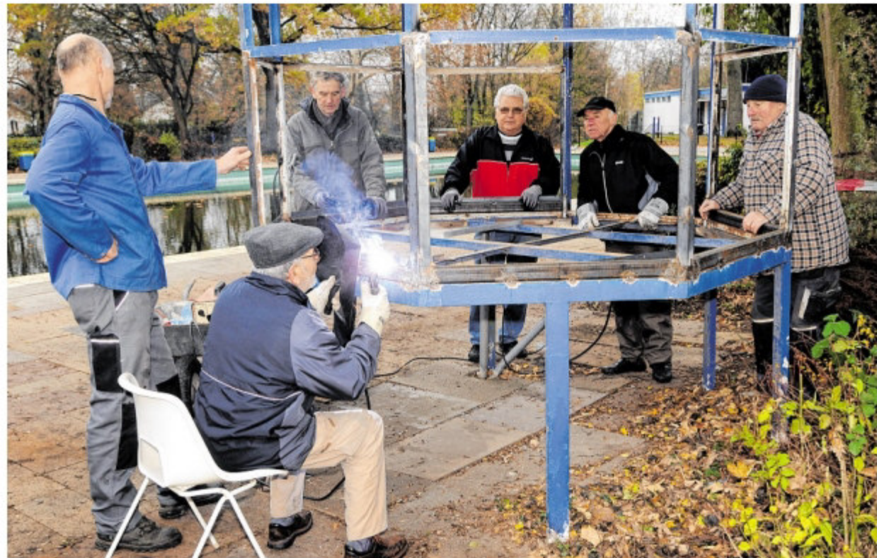
Der Förderverein Voerder Bäder ist gerade dabei, den Schwimmmeisterturm, von dem nur noch das „Gerippe“ steht, zu sanieren.
